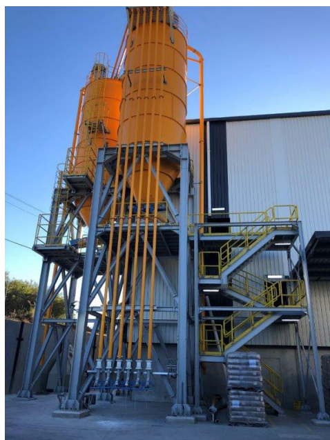
Nouvelle fabrique de mortier en Australie.
